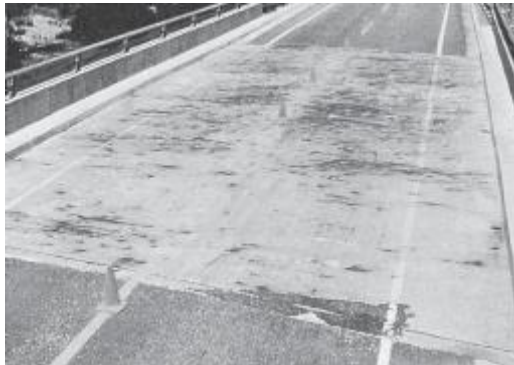
교량 바닥판의 철근 부식
